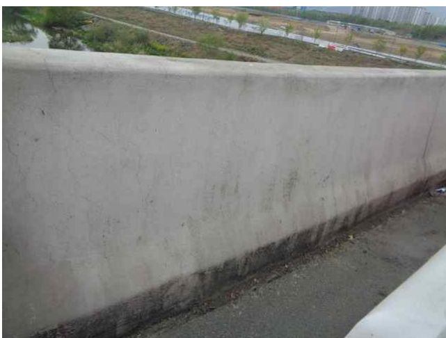
■ 부 재 : S9 ■ 손 상 : 방호벽 망상균열
