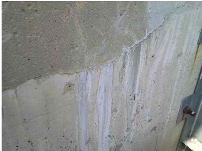
■ 부 재 : P7 ■ 손 상 : 코핑부 철근노출
