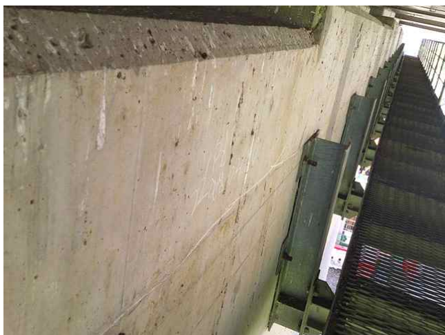
■ 부 재 : P7 ■ 손 상 : 코핑부 균열(폭 0.2mm)
