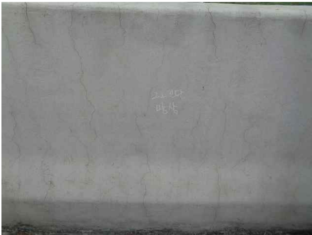
■ 부 재 : S6 ■ 손 상 : 방호벽 망상균열
