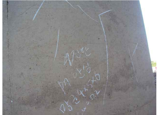
■ 부 재 : P7 ■ 손 상 : 기둥부 망상균열(폭 0.1mm)
